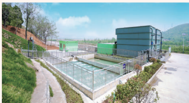
中色大冶丰山铜矿水处理设施
